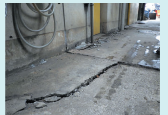
破碎選別工場/避難通路の破損
