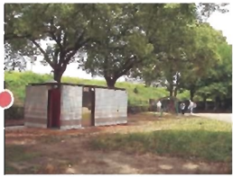
▲南町から南浦和園町へ、十三高副都心道の地下道工事始まる
